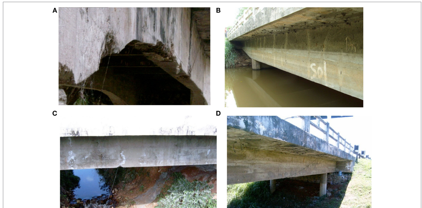
FIGURE 5 | Damages observed in bridges with different damage indexes. (A) DI = 0.15 (Roncador). (B) DI = 0.19 (Boa Esperança). (C) DI = -4.29 (Escuro). (D) DI = -6.82 (Iriú).
